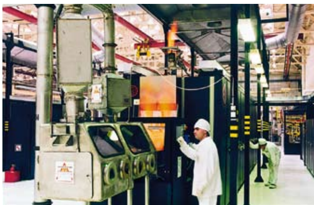
Конвейерная электрическая печь спекания топливных таблеток
